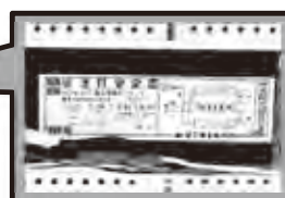
安定器の銘板を確認
